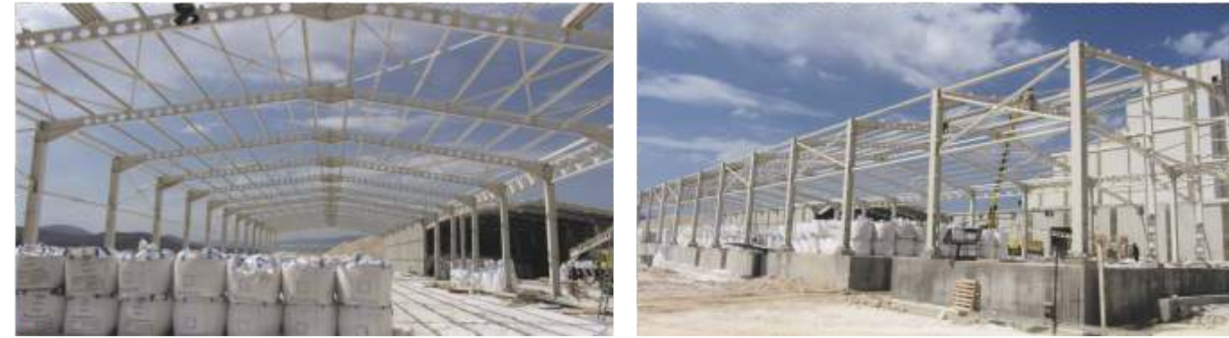
Kuvars kırma eleme tesisi
